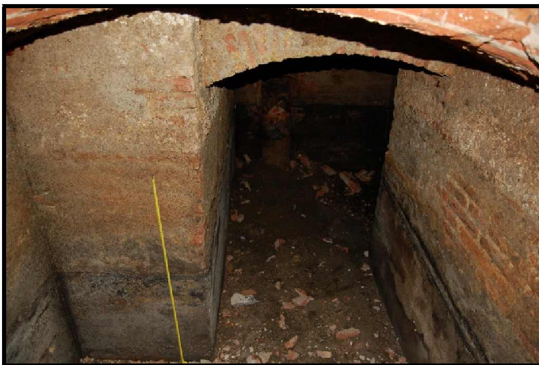
Foto 4. Vista de l'interior de la fossa en el punt on el cos principal es projecta fins el carrer amb un segon àmbit més estret cobert de volta en sardinell.
